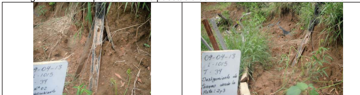
Figura N° 3. 6 Exposición de las puestas a tierra en la torre 34 de la línea 1015
