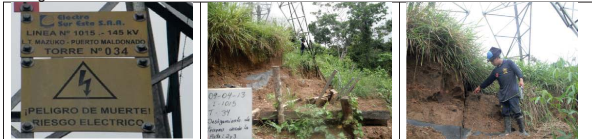
Figura N° 3. 5 Deslizamientos de terreno de la base de la torre 34 de la línea 1015
