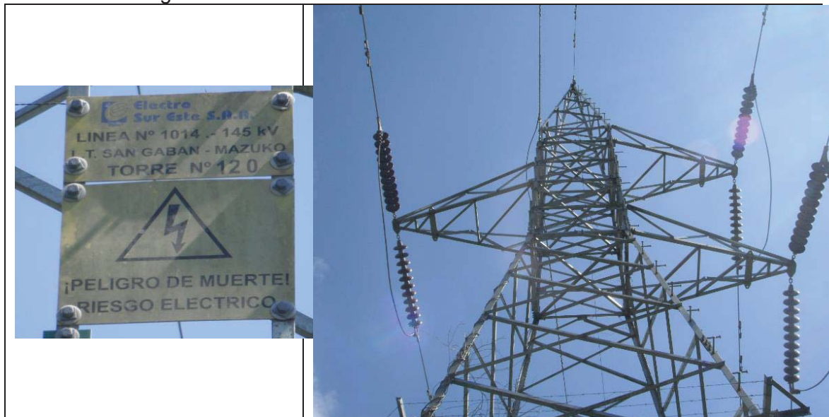
Figura N° 3. 13 Aisladores de la torre 120 de la línea 1014.
