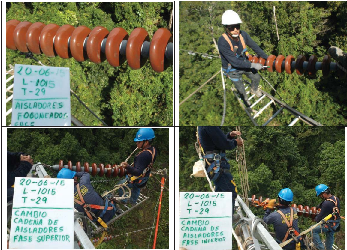
Figura N° 3. 16 Se muestra el proceso de Cambio de la cadena de aisladores en L-1015 torre 29
