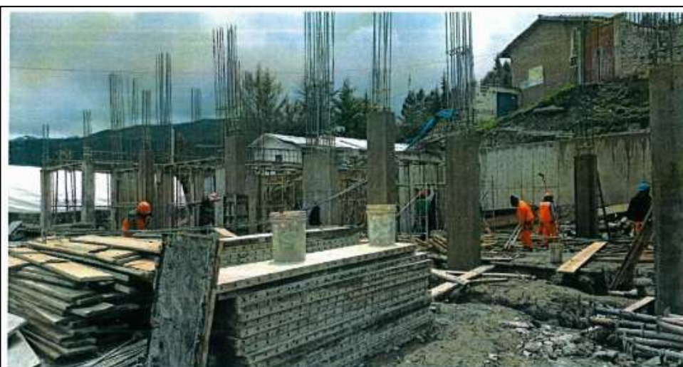
IMAGEN 08. ENCOFRADO DE FONDOS DE VIGA PARA LOSA DE ENTREPISO EN BLOQUE N°02.
