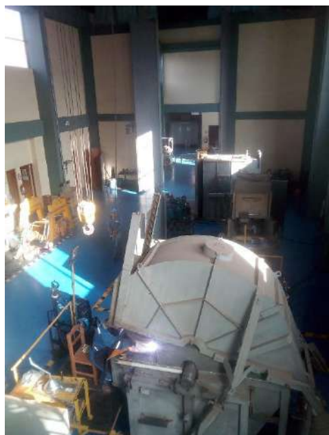
Hornos de precalentamiento de rodetes Pelton
