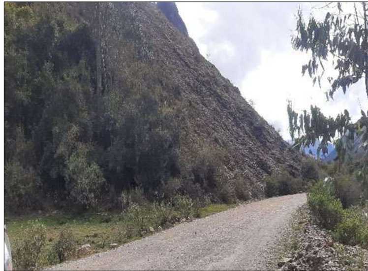
Fotografía 28: Desprendimiento de clastos de rocas (detritos) dispuestos sobre el talud superior de la vía.
