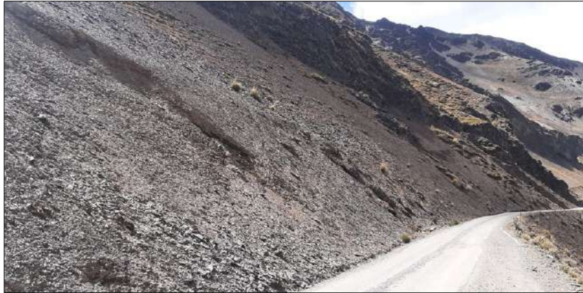
Fotografía 12: Vista panorámica del talud susceptible a deslizamiento, apreciándose depósitos de materiales de cobertura, clastos sub angulosos de diferentes diámetros de pizarras provenientes de desprendimientos de rocas de los picos Km 02+240 a Km 02+480.
