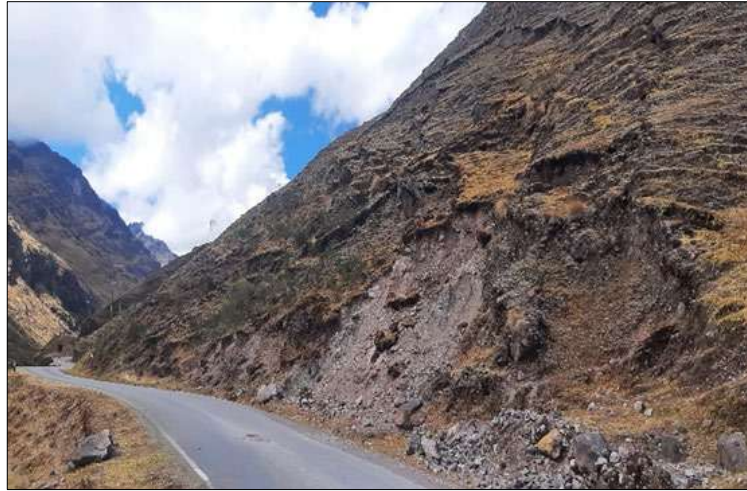
Fotografía 21: Deslizamiento de talud antiguo activo presentando pequeños desmoronamientos.
