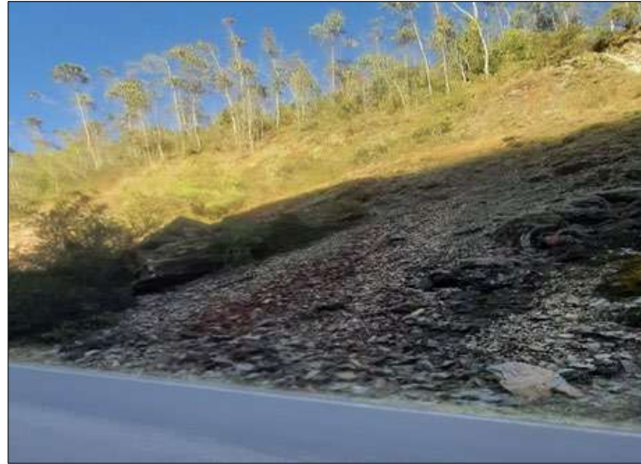
Fotografía 24: Desprendimiento de clastos de rocas provenientes de la parte superior del afloramiento rocoso.
