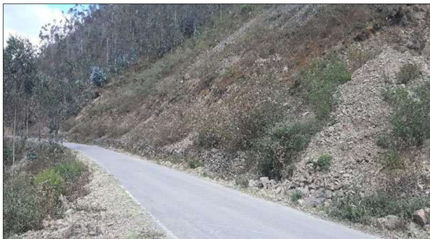
Fotografía 30: Desprendimiento de clastos de rocas (detritos) dispuestos sobre el talud superior de la vía.
