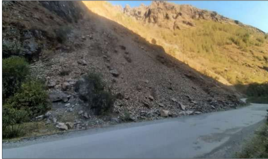
Fotografía 26: Desprendimiento de detritos sobre talud superior de vía.
