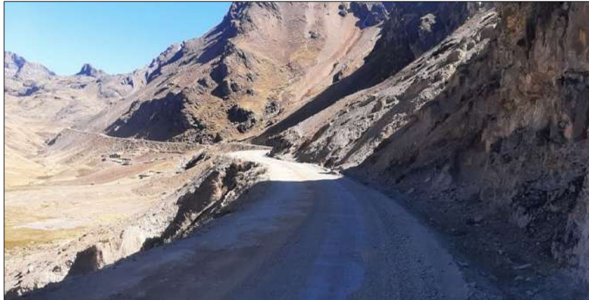
Fotografía 10: Zona susceptible a deslizamiento material de cobertura poca consolidación Km 01+770 a Km 01+940.
