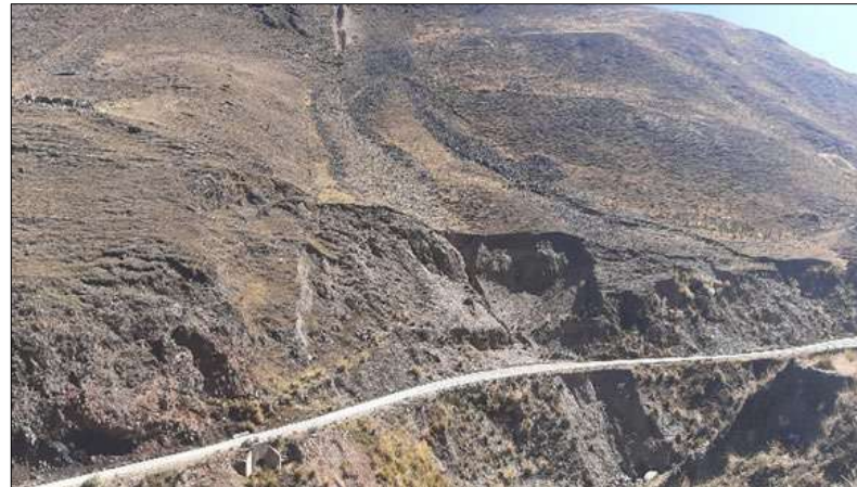
Fotografía 20: Vista del deslizamiento, apreciándose canales surcos, y grietas tensionales Km 00+465 a Km 00+565.
