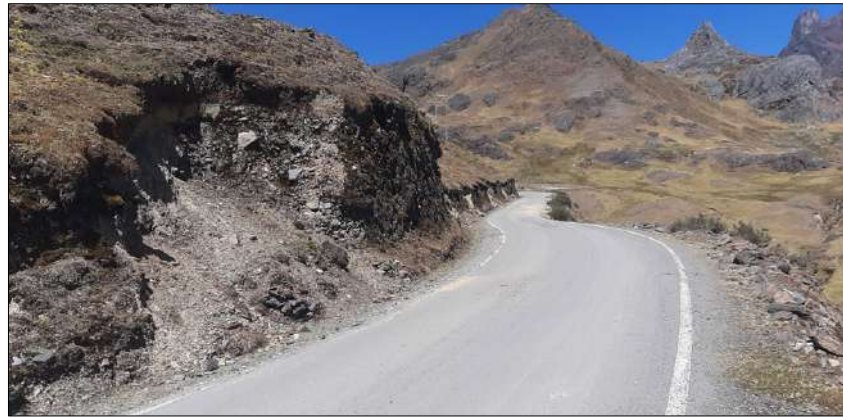
Fotografía 6: Vista de las laderas de montaña con depósitos coluviales provenientes de las partes altas.
