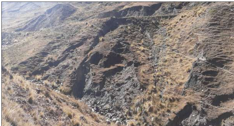
Fotografía 7: Se aprecia deslizamiento de talud inferior de la plataforma mostrando grietas tensionales de coronación en el Km 00 +320 – Km 00+345.
