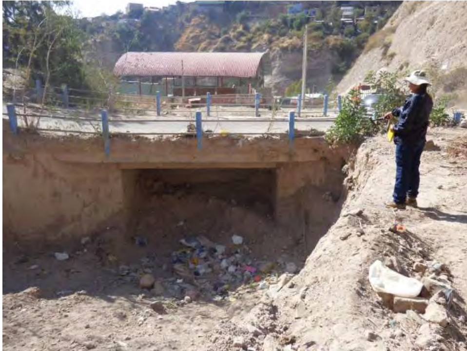
Fotografía 22. Vía Ayacucho – Sector Mollepata, se observa el paso del cauce de la quebrada Picota colmatado por depósitos de flujos de lodos antiguos.
