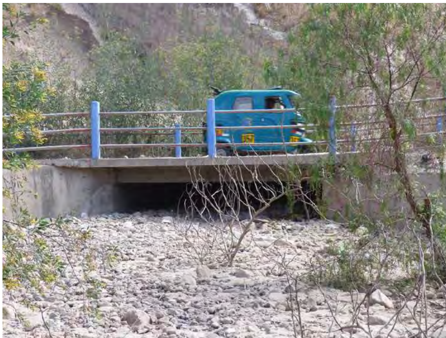
Fotografía 11. Piedemonte aluvio torrencial producto de los flujos de detritos y lodo por la remoción del material disponible en las laderas y cauce de la quebrada.
