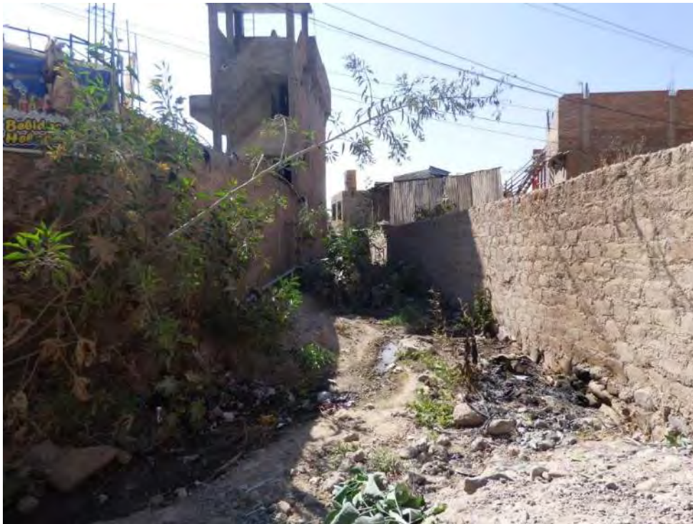
Fotografía 23. Viviendas asentadas dentro del cauce de la quebrada, invadiendo el cauce natural de la quebrada, considerado como zona con nivel de peligrosidad muy alto.
