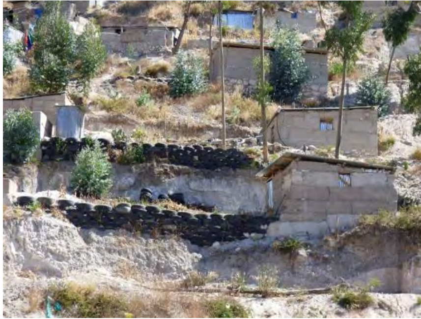
Fotografía 26. Vista de viviendas asentadas en las laderas con pendientes fuertes, donde realizan cortes de talud y sostenimiento del terreno con neumáticos viejos, zona considerado con nivel de peligrosidad alta, ubicada en la ladera de la margen derecha de la quebrada.
