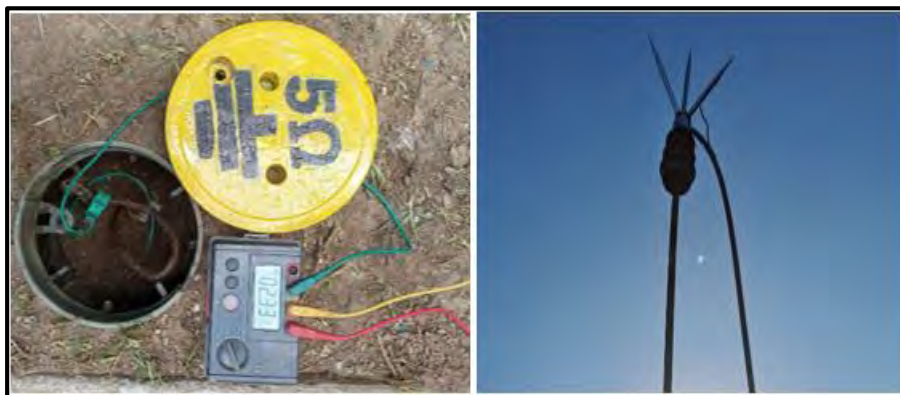
Sistema de Puesta a Tierra
