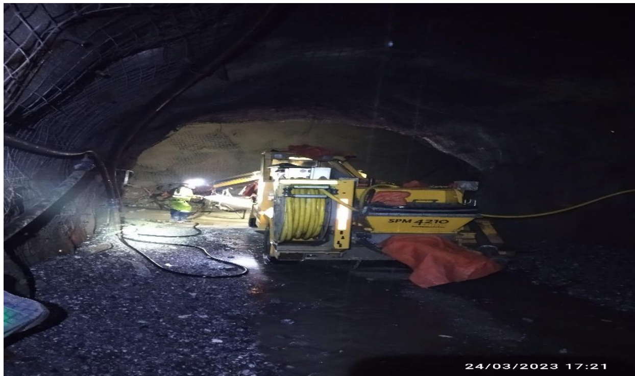
Figura 18: Preparación e instalación de equipo robot en el frente de lanzado de shotcrete.
