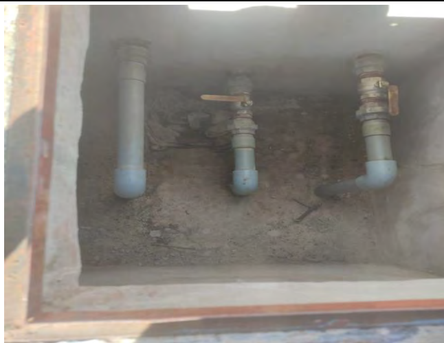
Fotografía 17: Caja de válvulas Capulichayoq
