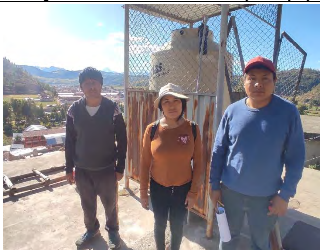
Fotografía 21: Sistema de cloración Capulichayoc
