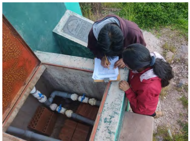
Fotografía 44: Caja de válvulas del reservorio
