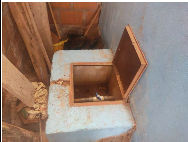
Fotografía 33: Caja de válvulas del reservorio
