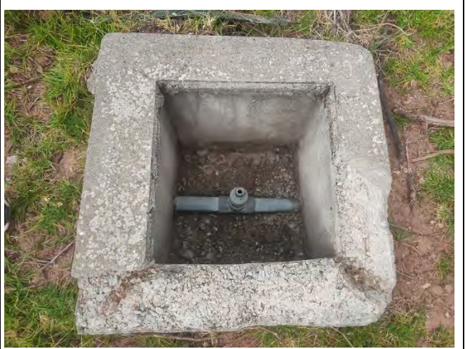
Fotografía 28: Válvula de aire
