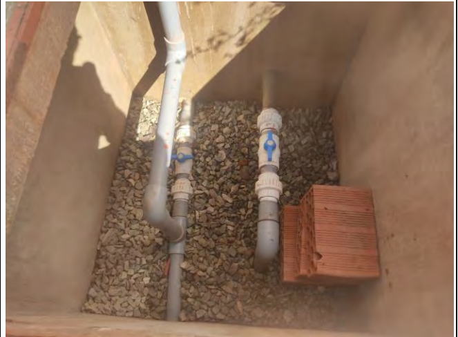
Fotografía 14: Caja de válvulas Niwachayoq
