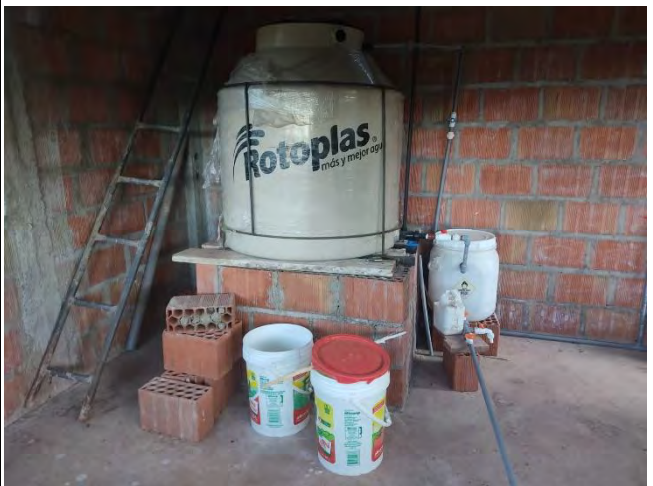
Fotografía 46: Sistema de cloración
