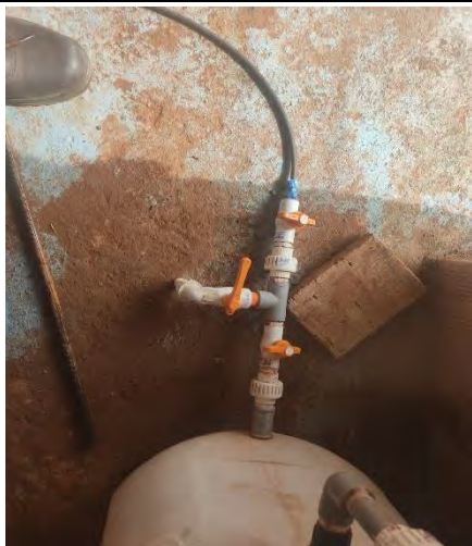
Fotografía 35: Sistema de cloración
