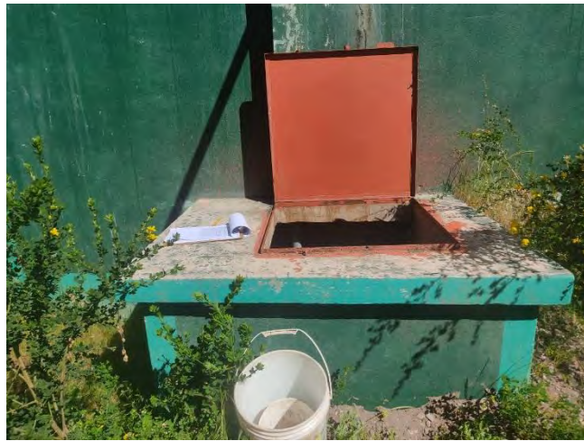
Fotografía 13: Caja de válvulas Niwachayoq
