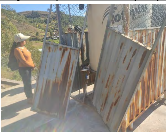
Fotografía 22: Sistema de cloración Capulichayoc
