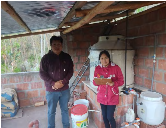
Fotografía 45: Sistema de cloración
