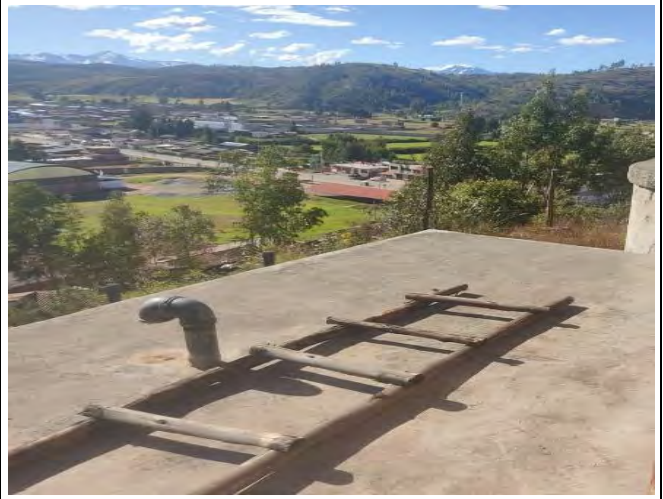
Fotografía 16: Tubería de ventilación Capulichayoq
