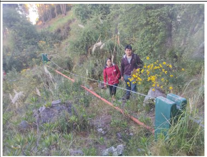
Fotografía 42: Pase aéreo de la línea de conducción
