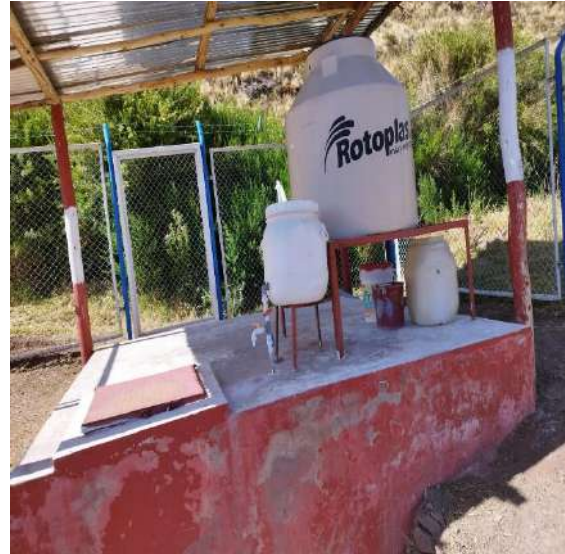
FOTO 2: reservorio y sistema de cloración del SAP de San Isidro de Carhuis.
