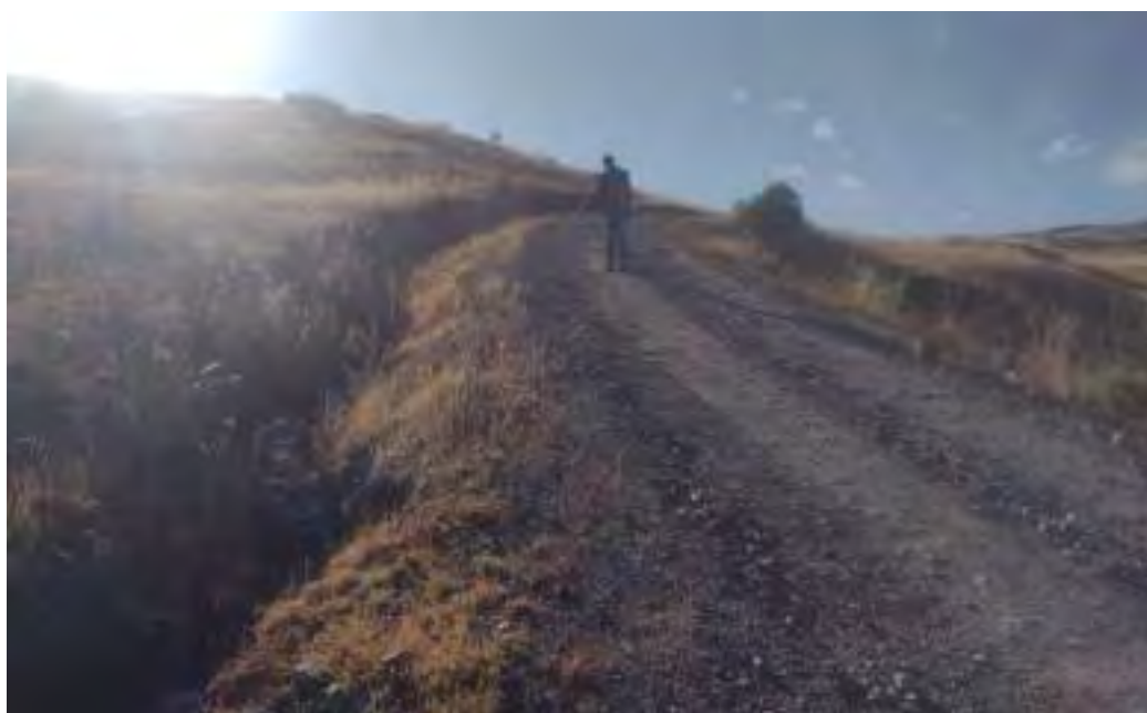
Figura N° 48 Estado situacional de cunetas
