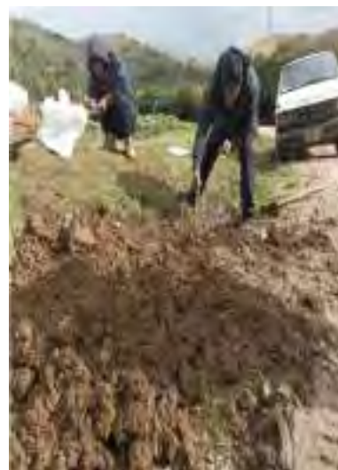
Calicata N°02 km: 02+060 – C.P Trancapata alta. Material fino de limo y arcilla plastidad baja color marrón oscuro con textura limosa arcilloso.
