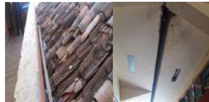
Figura 13 Techo deteriorado y presencia de humedad
