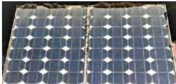
Figura 24: Formación de musgos en un panel fotovoltaico (Elaboración propia).
