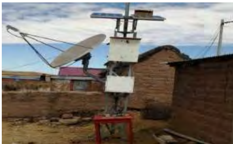
Figura 48: Medición de variables ambientales y potencia de un panel fotovoltaico (Elaboración propia).
