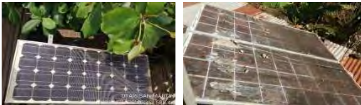
Figura 25: Presencia de sombra, oxido y excremento de aves sobre los paneles solares (Elaboración propia).
