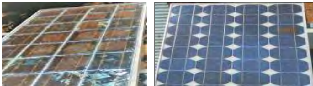
Figura 23: Efecto del punto caliente de un panel solar (Elaboración propia).
