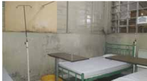
Foto 3: humedad en área de internamiento tanto en paredes y pisos C.S. Mazuko
