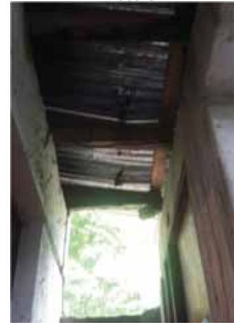
Estructura de techo y cubierta deteriorada. Fuente: Unidad de proyectos-2014.
