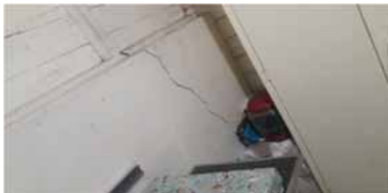
Foto 2: fisura evidente en el sector de áreas generales,
