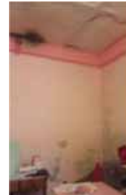
Foto 4: filtraciones en el área de consul torios, C.S. Mazuko
