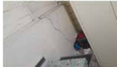
Fisura en zócalos de concreto. Fuente: Unidad de proyectos-2014.
