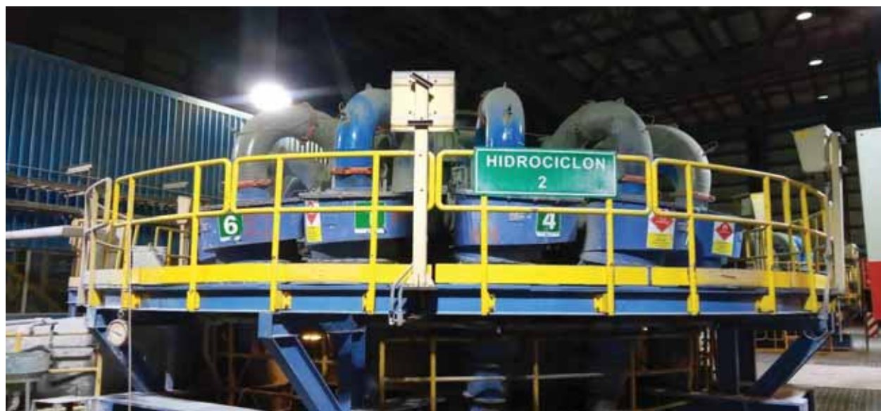
Nido de Hidrociclones N°2
