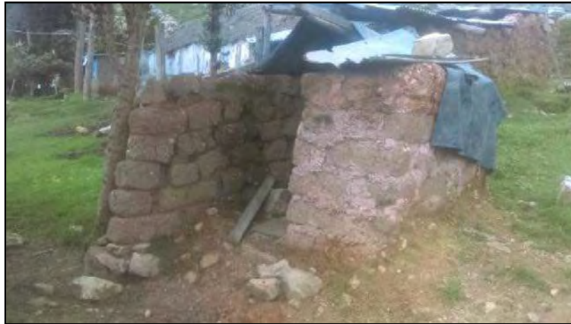
Figura 11, Unidad Básica de Saneamiento, en estado de colapso.
