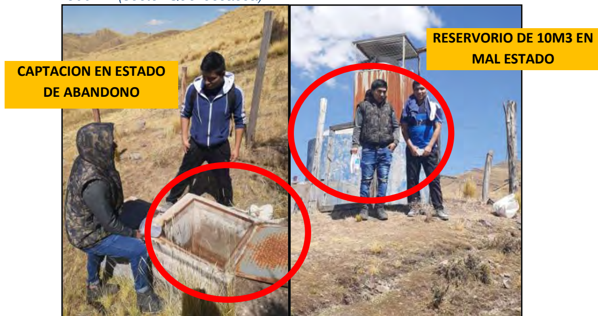
Figura 7, Se aprecia que existe oxido en la captación y el reservoirio temporal de 2500 LT (sector Quelloccacca)
