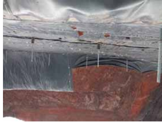
Figura 16. Geo membranas y chimeneas
