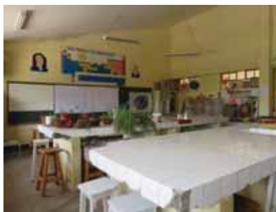
Vista de las mesas de laboratorio enchapados con cerámica de 0.20 x 0.30 en mal estado de conservación.
