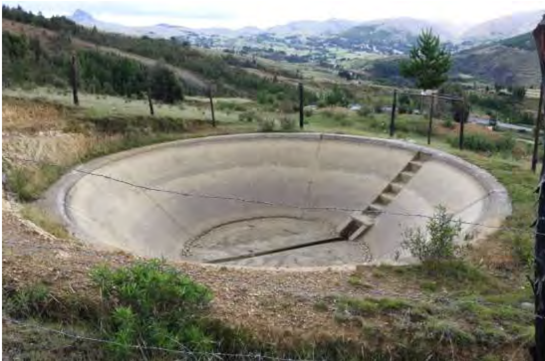
Fotografía N° 06. Reservorio para sistema de riego presurizado
