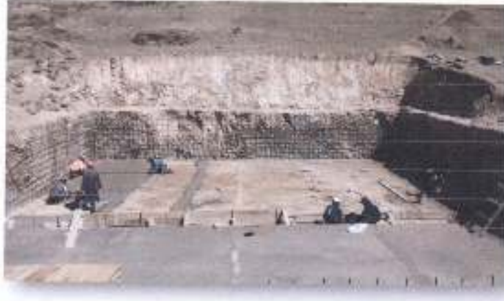
PLANTILLADO DEL SOLADO DEL RESERVORIO Y VACIADO POR PAÑOS UTILIZANDO REGLAS PARA SU ACABADO FINAL
