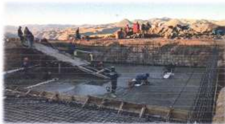
ACABADO DE LAS JUNTAS DE DILATACION Y PULIDO DEL PISO DEL RESERVOIRIO
