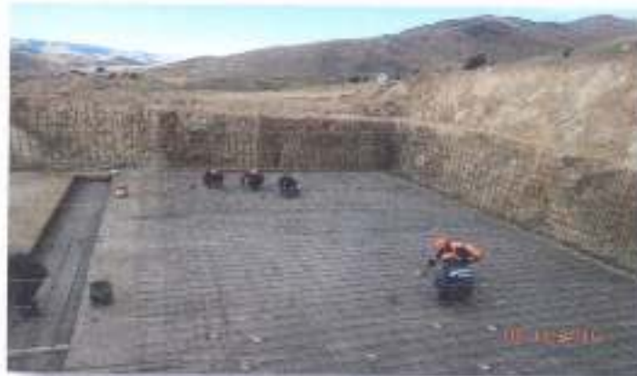
COLOCADO DE FIERRO EN EL PISO DEL RESERVORIO NOCTURNO UTILIZANDO CADOS DE CONCRETO
