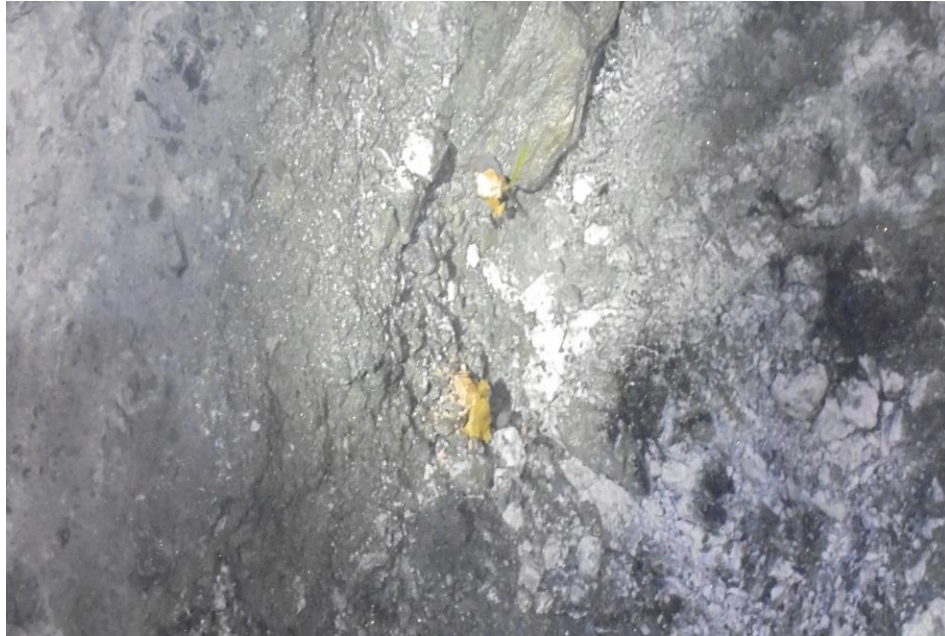
Ilustración 7. Supervisión deficiente – Tiro cortado por terreno con presencia de diaclasas y fallas paralelas, subhorizontales y presencia de agua.
