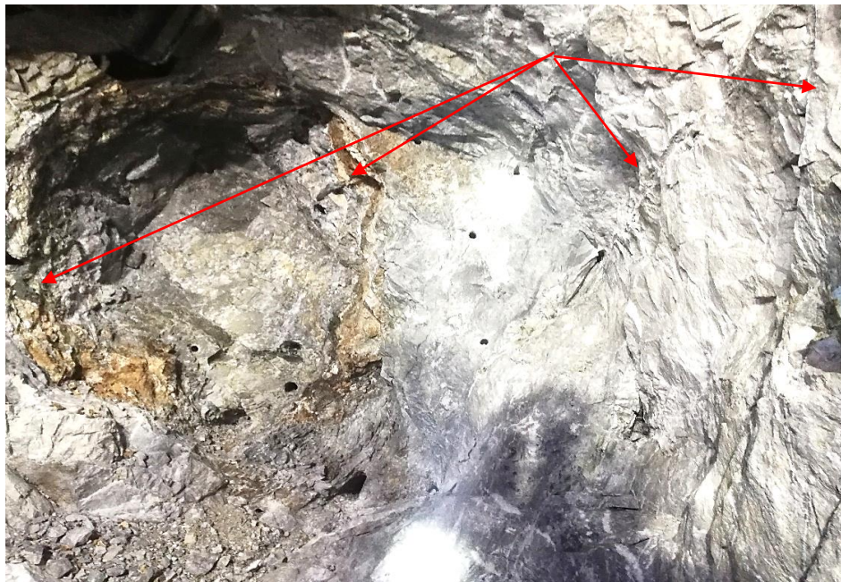
Ilustración 8. Ausencia de Paralelismo - Tiros anillados y cortados por falta de supervisión en el momento de la perforación e incorrecta perforación
