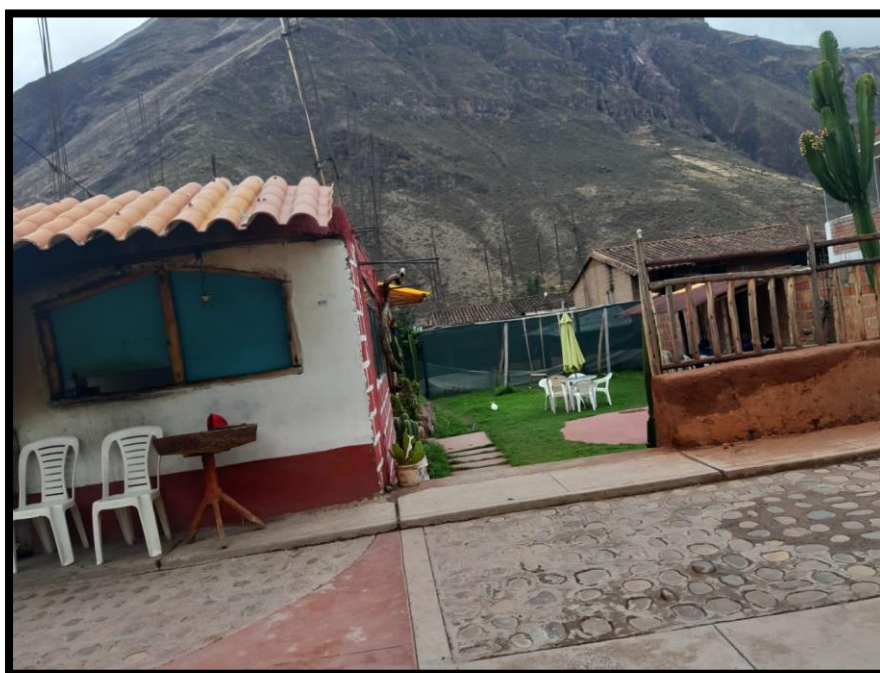
INSTALACIONES DEFICIENTES DE LA FERIA GASTRONOMICA
