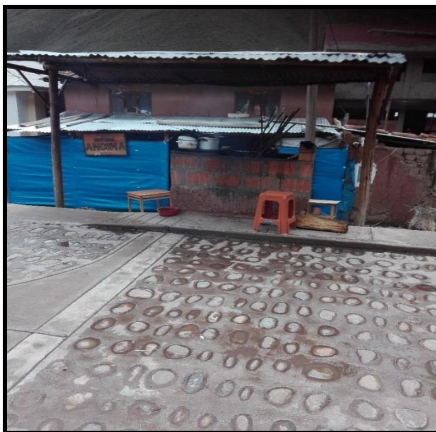
INSTALACIONES DEFICIENTES DE LA FERIA GASTRONOMICA
