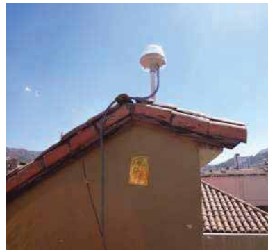
Vista de la ERP CS01 instalado en el techo de la Sede del Gobierno Regional del Cusco – Plan MERISS.
