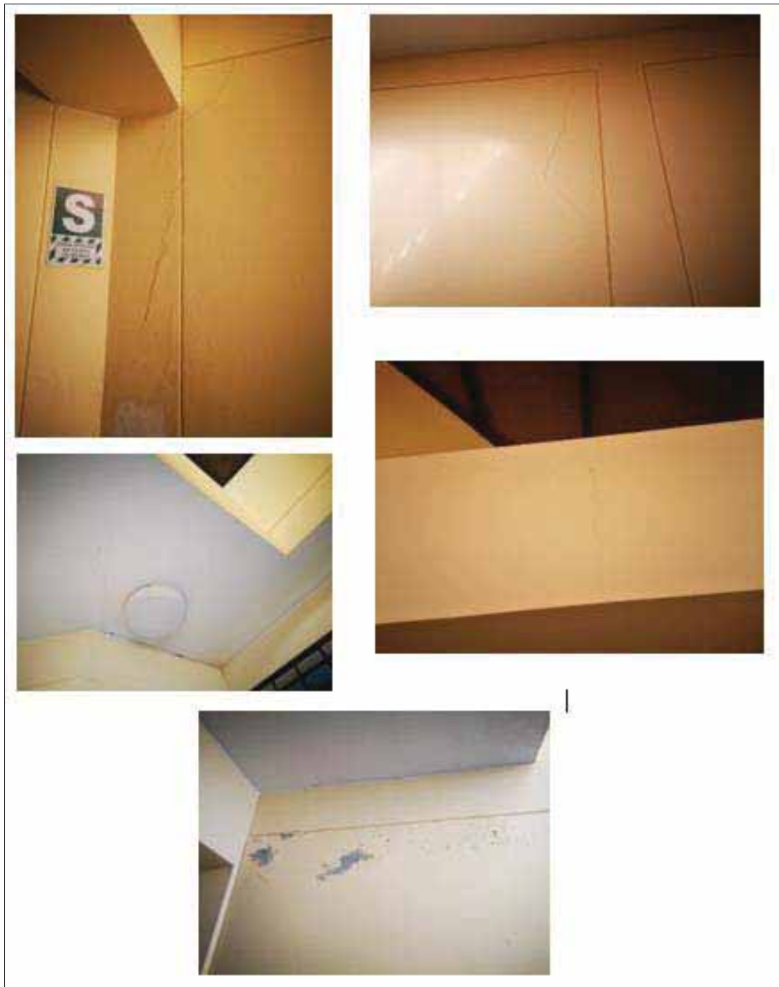
Figura 52. Fisuras presentes en los elementos estructurales en los últimos niveles
