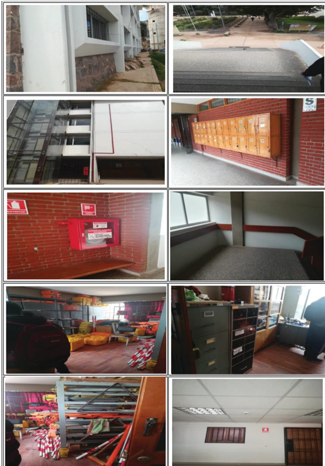
Figura 65. Estado de los componentes No Estructurales
