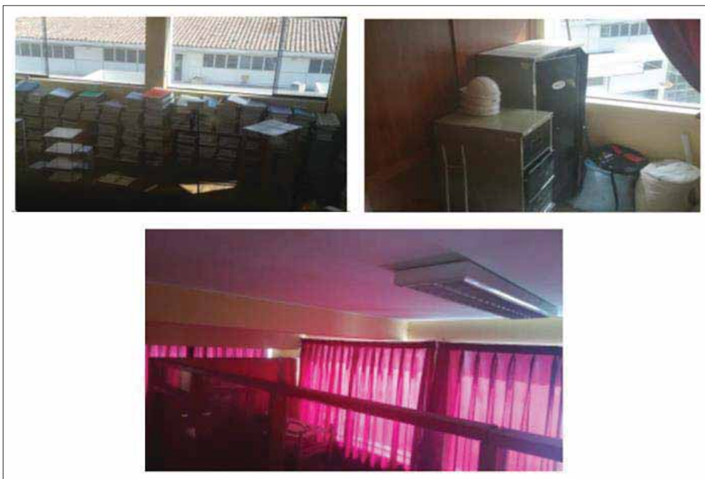
Figura 56. Mobiliario sin anclaje.
