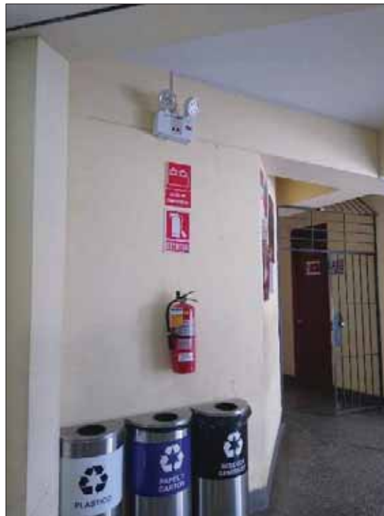
Figura 54. Luces de emergencia y extintor
