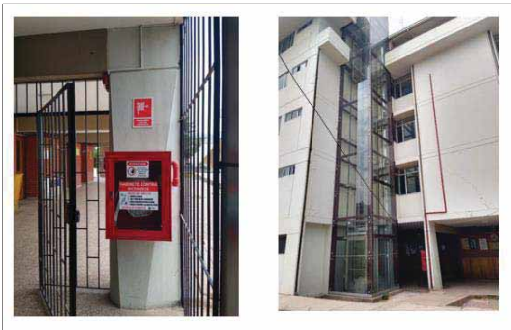
Figura 64. Tubería contra incendio correctamente anclada y moderna al igual que la estructura del ascensor
