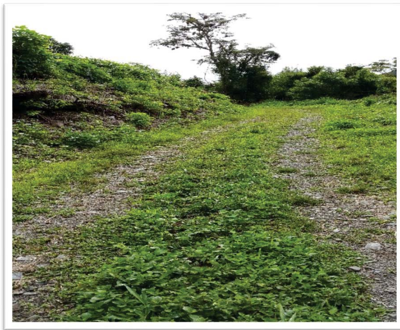
ESTADO DE LA VÍA
