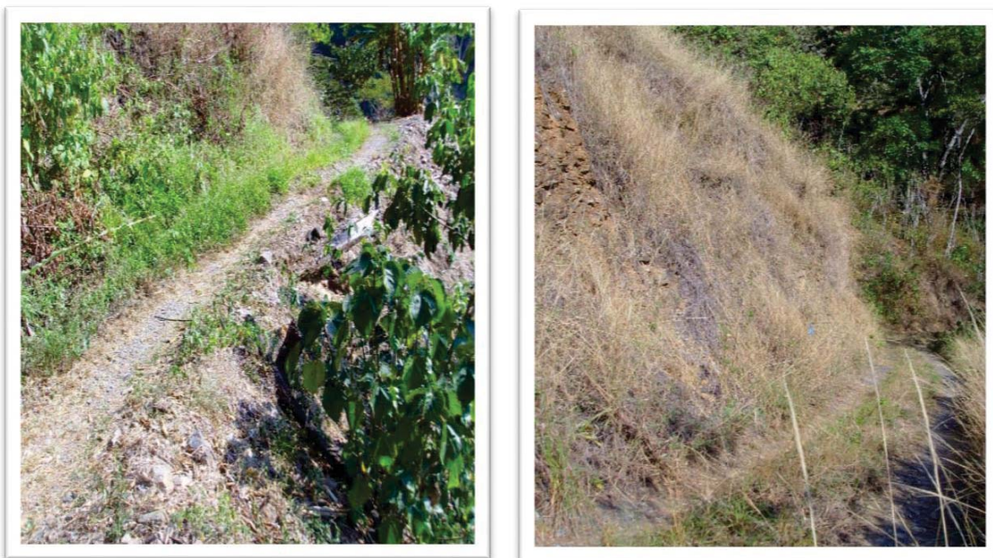
Imagen 05-06: Trochas carrozables que le faltan ampliacion y limpieza.
