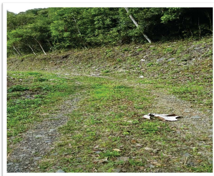
PERDIDA DE BOMBEO Y AUSENCIA DE CUNETAS
