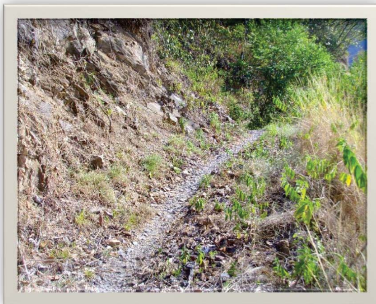
Imagen 02: Falta de limpieza y mantenimiento de las vías existentes.
