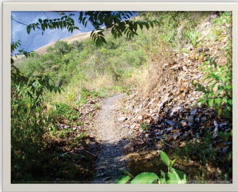
Imagen01: Vista del derrumbe del talud de la trocha carrozable existente.
