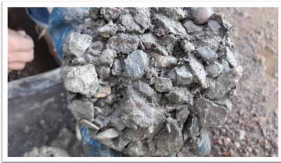
Figura 19. Desencofrado con deficiencia de pasta entre agregados.
