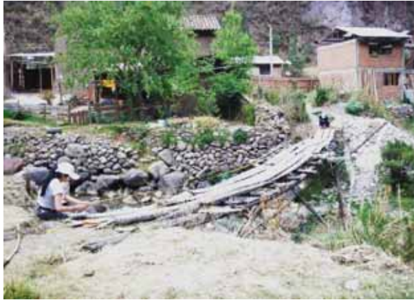
Fotografía N°7: Se observa la medición de la segunda sección, puente de madera en malas condiciones.
