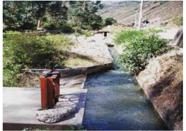
Fotografía N°14: Se observa al otro lado del río Qochoq otra compuerta de la captación de un canal de irrigación
