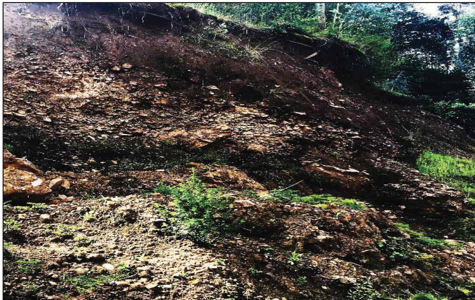
Imagen 14: Depósitos coluviales asentados en la carretera del centro poblado de Machacancha.: Elaboración propia
