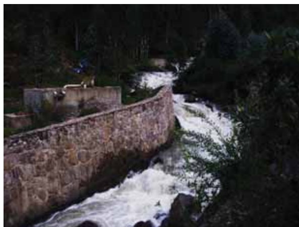
Fotografía N°17: Se aprecia a la altura de la población de Mesacancha la presencia de un muro a uno de los laterales del río Qochoq.
