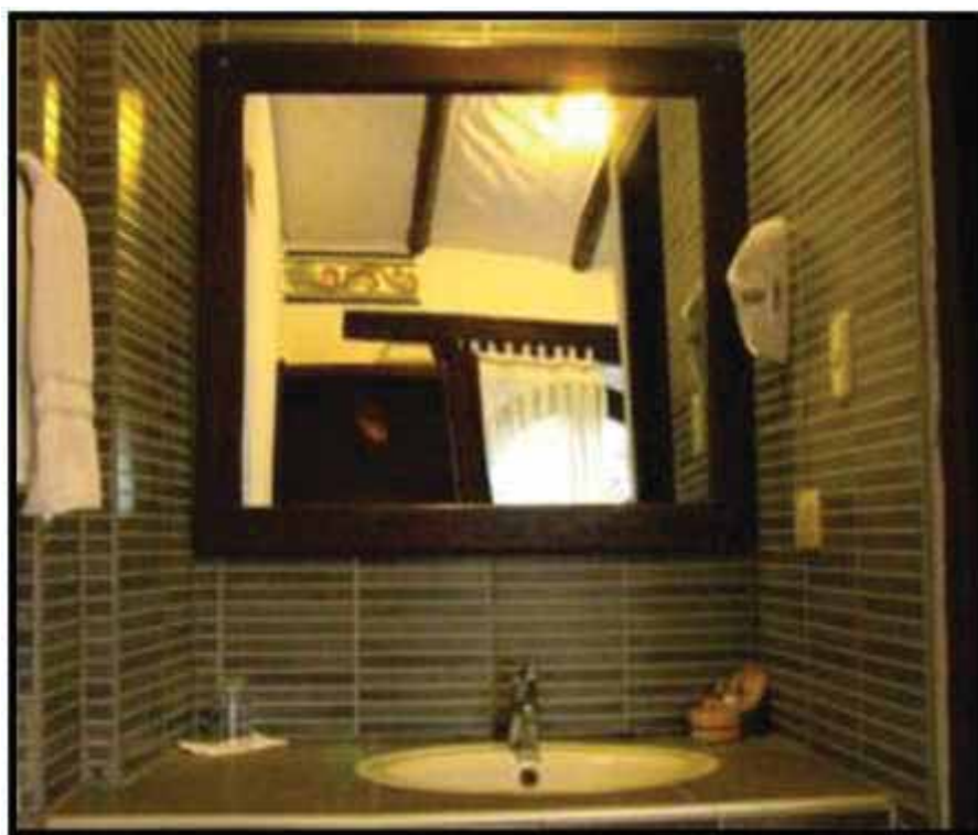
Ilustración 7: Se instalaron sistemas de ahorro de agua (grifos ecoeficientes) en los baños de las habitaciones.
