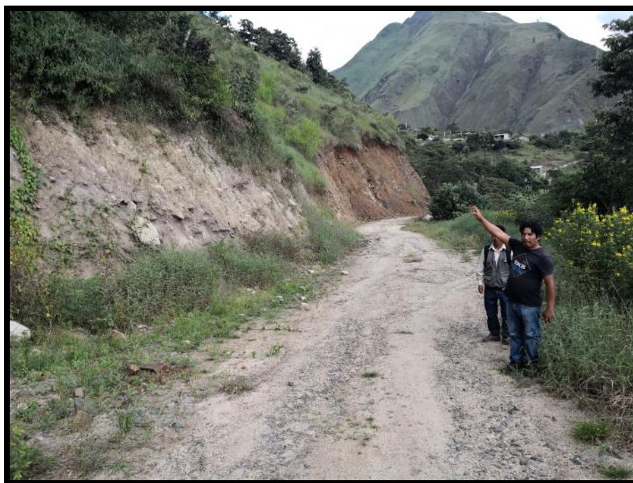
IMAGEN N° 16. VISUALIZACION E INSPECCION DE TALUDES EN EL ANTIGUO TRAZO PARA SU RESPECTIVO CUMPLIMIENTO CON LA NORMA VIGENTE.
