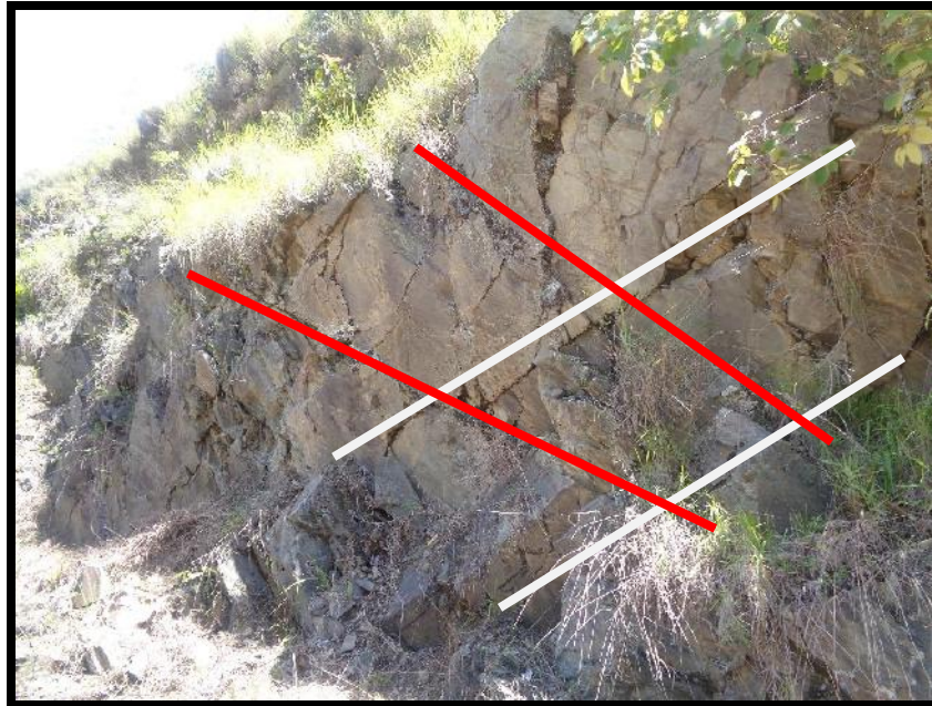
IMAGEN N° 8. ROCA FRACTURADA, LA CUAL PRESENTA DIFERENTES SISTEMAS DE FRACTURAMIENTO, SEPARACION Y SU CORRESPONDIENTE ESTRATIGRAFIA.
