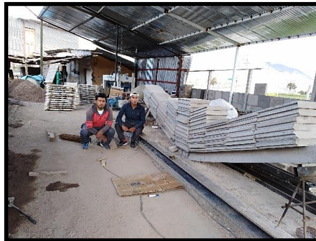
Ilustración 60: momento de falla de viga pretensada
