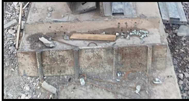
Ilustración 37: anclaje de rieles de sujeción.
