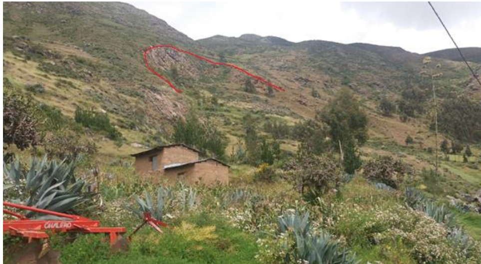
Foto 9 .- Deslizamiento (Fuente propia)
