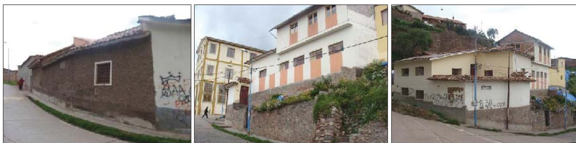
Fig. 285. Vista externa del predio, donde se evidencia un muro de contención contemporáneo sin material reutilizado.
