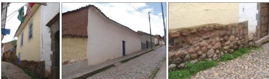
Fig. 281. Vista externa del predio, con evidencia de material lítico reutilizado en el sobrecimiento del inmueble.
