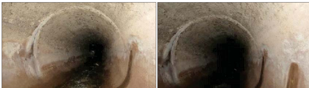
Fig. 393. Vista de la canalización del Río Saphi desde la intersección con la calle Amargura hasta la calle Tigre, con material de concreto armado.
