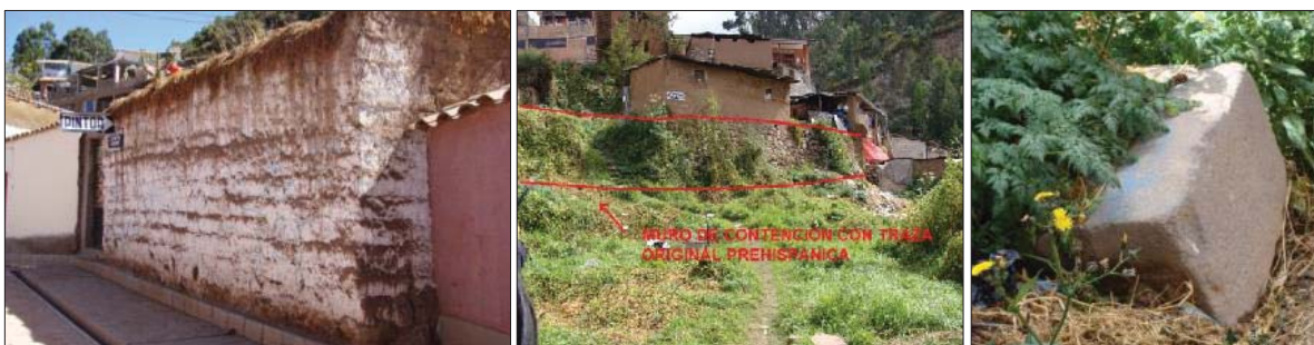
Fig. 71. Vista externa e interna del predio, donde el círculo rojo muestra la presencia del muro de contención con material lítico Prehispánico (Inka) reutilizado.
