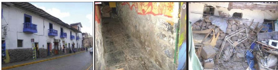
Fig. 314. Vista externa del inmueble con evidencia de muro con material reutilizado. En el interior observa parte del zaguán de acceso con material reutilizado, así mismo se tiene un montículo de elementos líticos prehispánicos.
