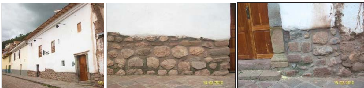
Fig. 270. Vista externa del predio, con evidencia de material reutilizado en la fachada principal del inmueble.
