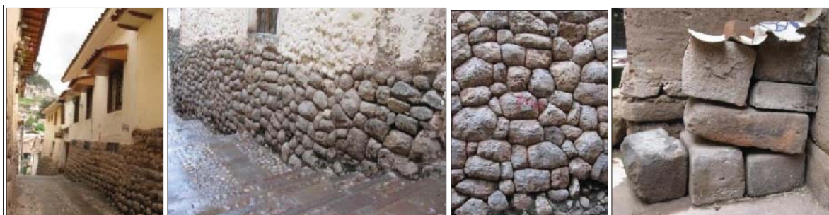
Fig. 124. Vista externa del predio con presencia de muro Inka a base de litos de material caliza en la calle ladrillos. Así mismo en el interior del inmueble se evidencian elementos líticos sueltos y reutilizado.
