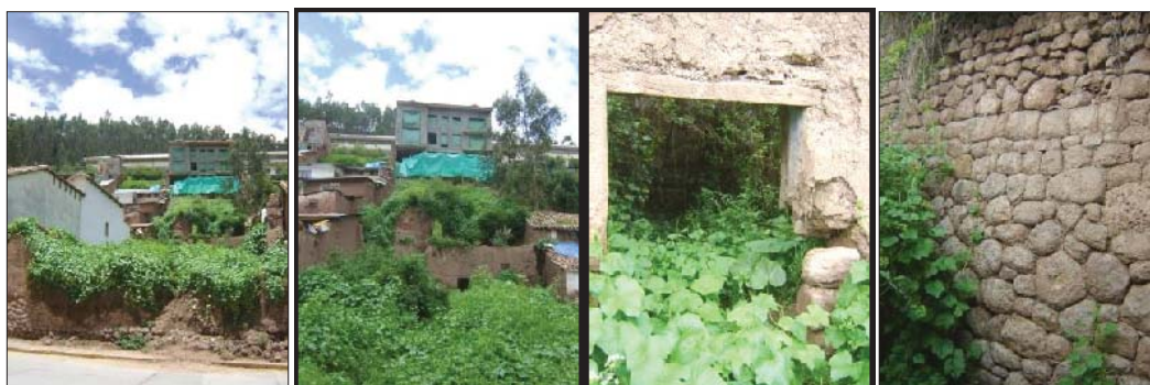
Fig. 384. Vista externa del inmueble con evidencia de material reutilizado. En el interior se evidencia un muro algunas estructuras colapsadas con litos reutilizados y un muro de contención Inka.
