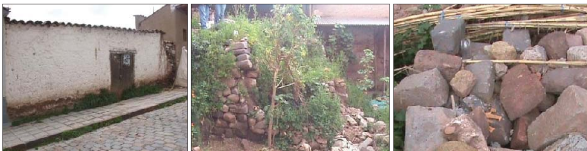
Fig. 280. Vista externa del predio, con evidencia de material lítico reutilizado. En el interior de observa colapso de estructura que presenta litos prehispánicos del tipo andesita y caliza.
