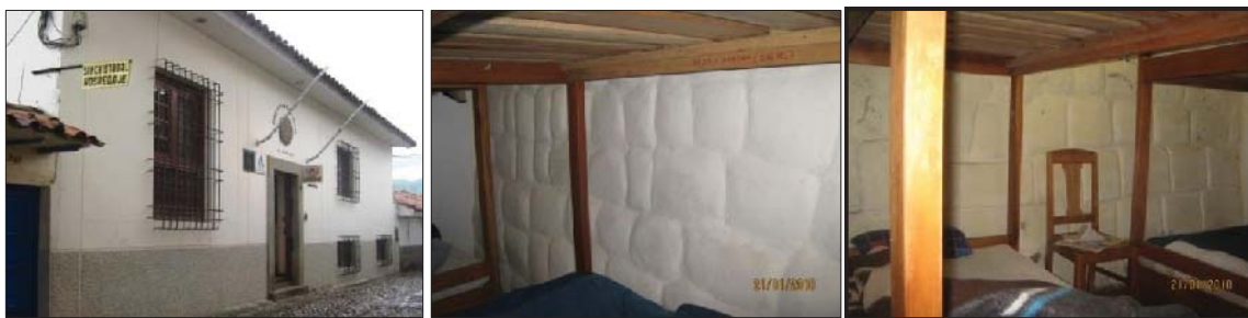
Fig. 215. Vista externa del predio. En el interior del inmueble se evidencia un muro de contención Inka cubierto por un material blanquecino (yeso), ubicado en el lado Norte del inmueble límite con la calle Kiskapata.
