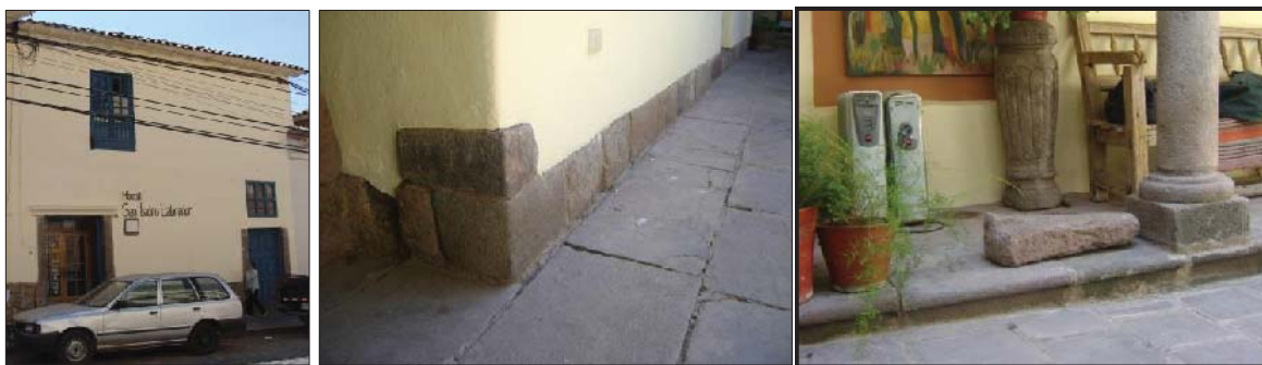
Fig. 248. Vista externa del predio. En el interior se evidencia sobrecimiento con material reutilizado, así como litos sueltos en el patio del inmueble.
