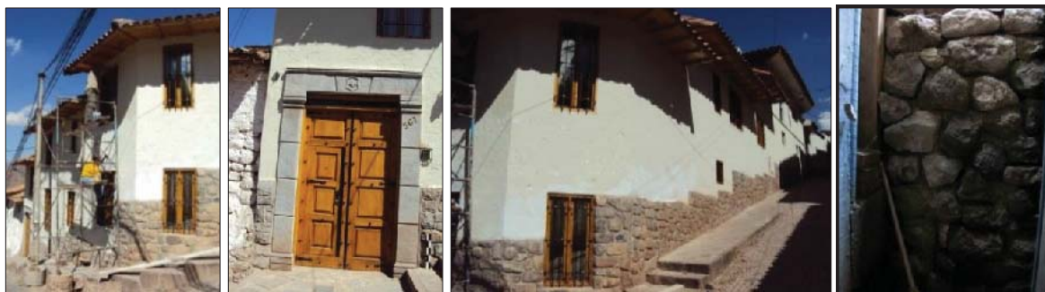
Fig. 168. Vista externa del predio, con material lítico reutilizado. En el interior del predio se evidencia un muro de con material reutilizado.
