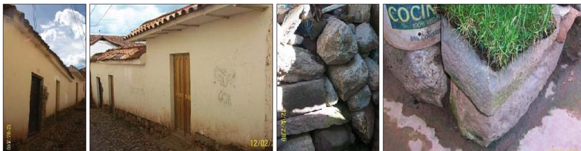
Fig. 258. Vista externa del predio con presencia de sobrecimiento con material lítico reutilizado. En el interior del inmueble se evidencia material lítico reutilizado y un montículo de litos prehispánicos.
