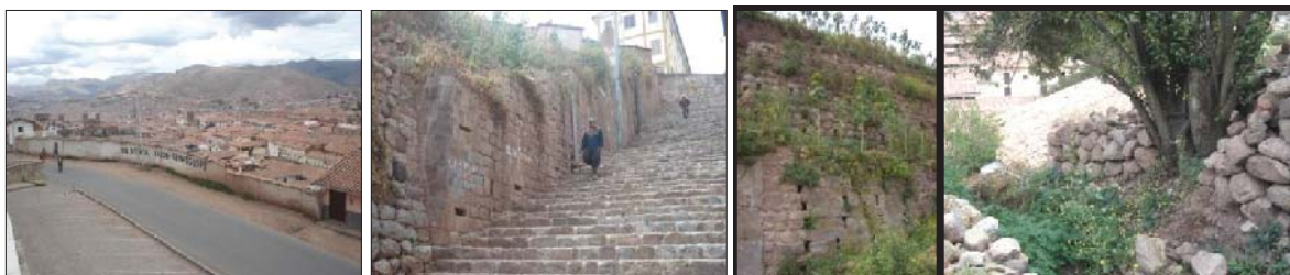
Fig. 377. Vista externa del inmueble con presencia de material lítico reutilizado. En el interior se evidencia un muro de contención con material lítico reutilizado, aunque no se distingue su originalidad, se evidencian gran cantidad de elementos líticos prehispánicos de material caliza sueltos
