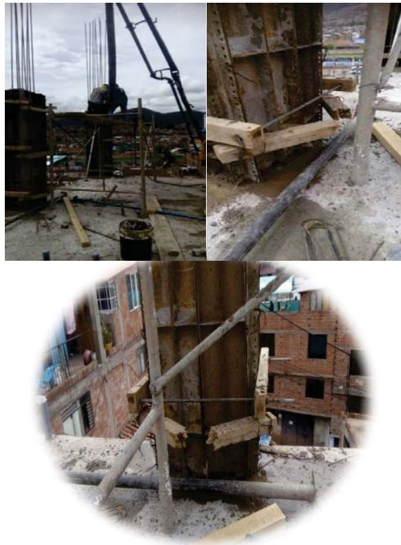
Figura N° 54: Fotografías del comportamiento estructural de una columna.
