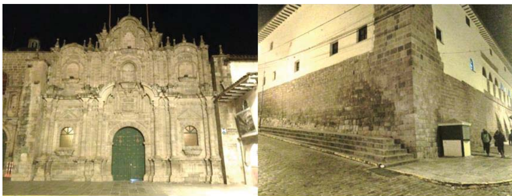
Imagen N° 18. Manchas de humedad, izquierda Paraninfo Universitario, derecha Convento de Santa Teresa (Fuente propia).
