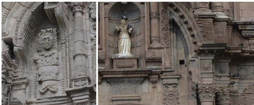
Imagen N° 17. Procesos patológicos de aves. Lado izquierdo ornamentación ensuciada de la Fachada Retablo del Paraninfo Universitario, lado derecho anidamiento de las palomas en la Fachada Retablo de la Compañía de Jesús (Fuente: Fuente propia).
