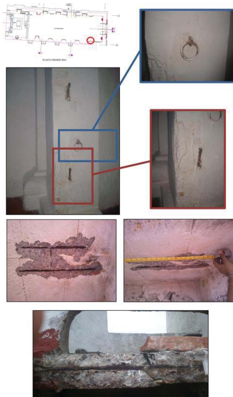
Imagen N° 31. Patologías Químicas: Corrosión y Oxidación. (Fuente: Evaluación y Diagnóstico Patológico de la Iglesia Santo Toribio de Mogrovejo de Cartagena de Indias. Gerardo L. Bustamante Martelo y Jorge L. Castillo Brieva, pág. 62).
