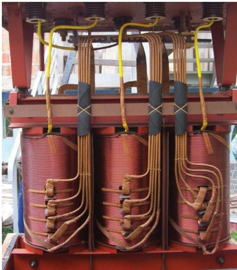
Figura 2.2: Componentes estructurales internas del transformador Fuente: Fotografía propia.
