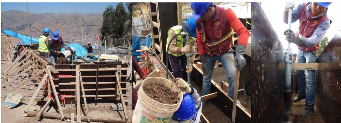
Actividades para la compactación de la mezcla de tierra con los agregados.
