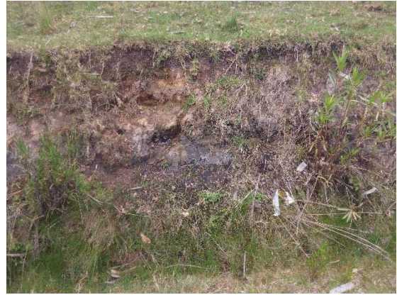
Suelos contaminados por lixiviados.
