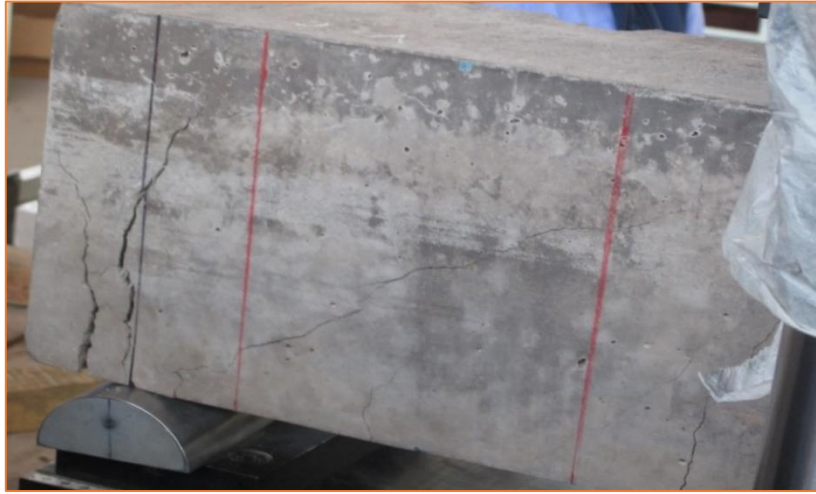
Figura 57. Inicios de la fisura inclinada debido a la concentración de esfuerzos en el apoyo
