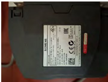
Placa del variador de frecuencia
