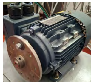
Motor eléctrico del excitador
