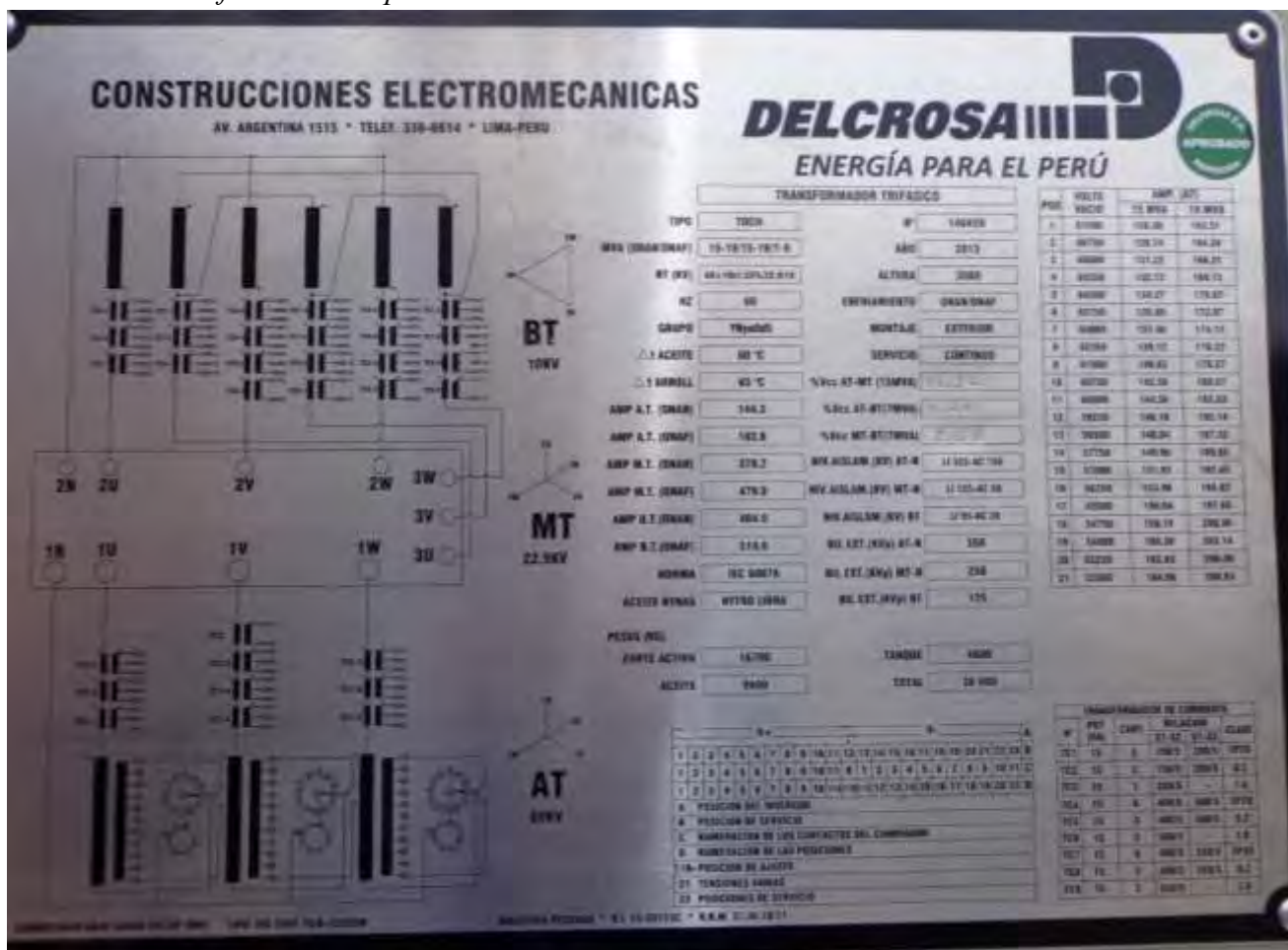
Figura 3.4 Placa del transformador de potencia SET Urubamba
