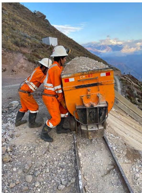
Imagen 27: Descarga en la tolva San Lorenzo.
