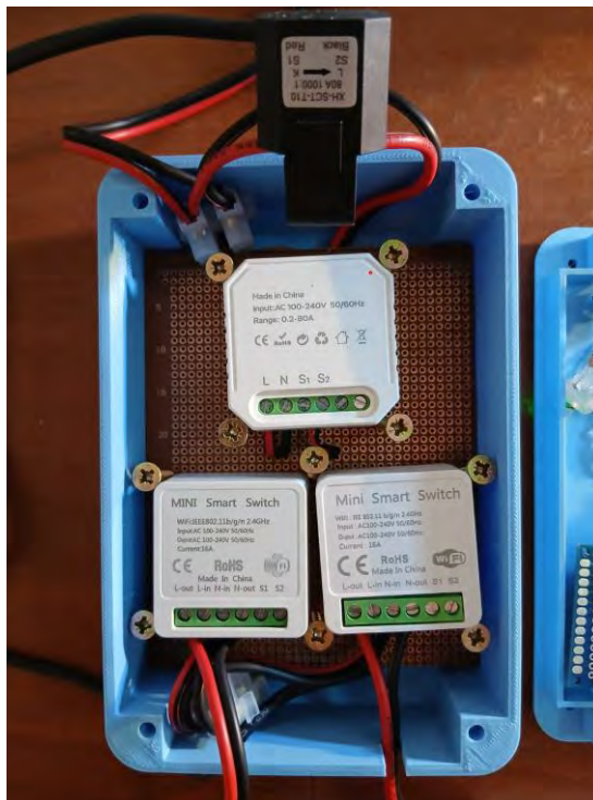
Anexo 01: Primera etapa del medidor: Módulo principal, TC e interruptores
