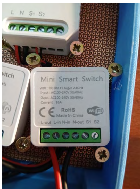
Anexo 07: Interruptor automático para el circuito de luminarias
