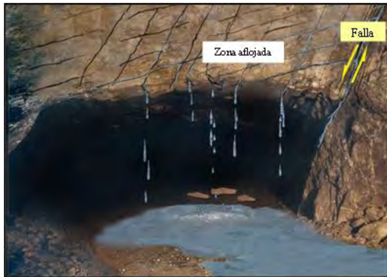
Figura 5 Presencia de agua
