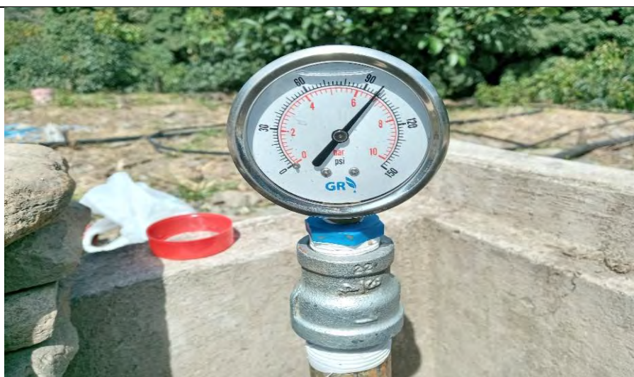
Fotografía 19.- se puede apreciar que tiene 6.9 bar de presión del hidrante en la parcela
