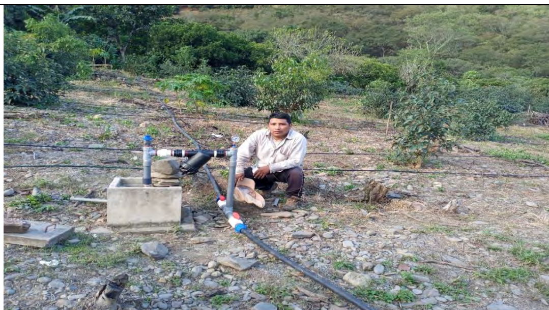
Fotografía 26. Instalación de cabezal de riego con su respectiva válvula de aire, medidor de presión que servirá para el control de agua así mismo el filtro de anillos color rojo de 2pulgadas
