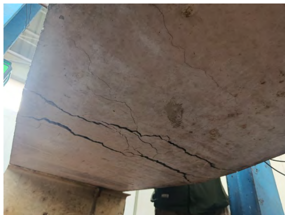
Figura 56: Fisuras de la losa maciza LM-02
