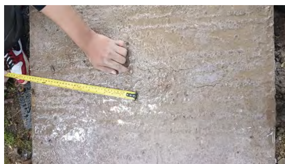
Figura 37: Verificación de fisuras de contracción en Losas LM-01, LM-02, LM-03, LM-04
