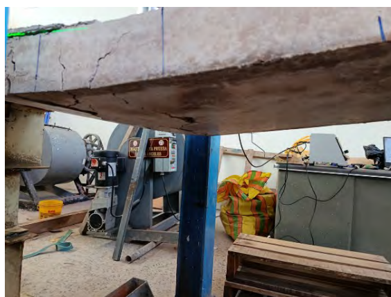
Figura 50: Fisuras de la losa maciza LM-01
