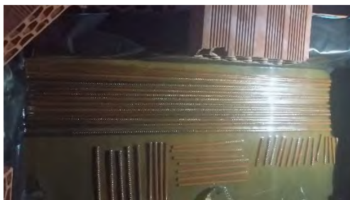
Fotografía 35. Corrosión del acero, día 1
