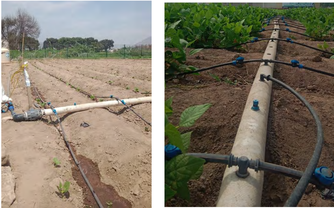
Fotografía N° 14. Riego por goteo en el área de investigación.
