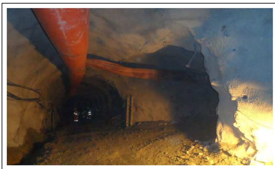
Mangas de ventilación
