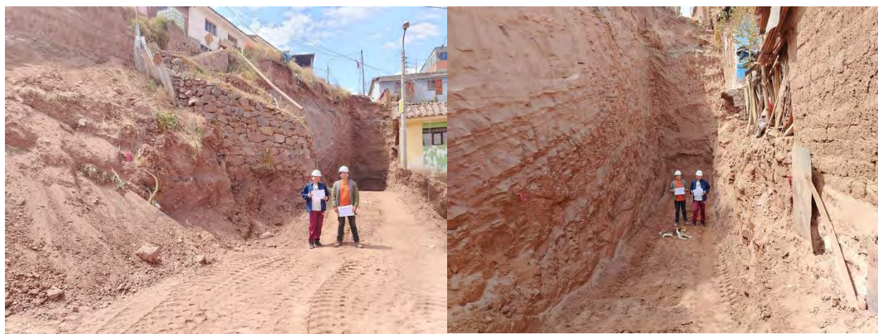
Figura 22. Talud descubierto en Pje. Mirador
