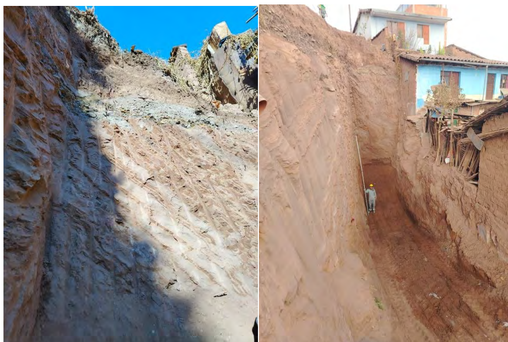
Figura 23. Estratos visibles en el talud.
