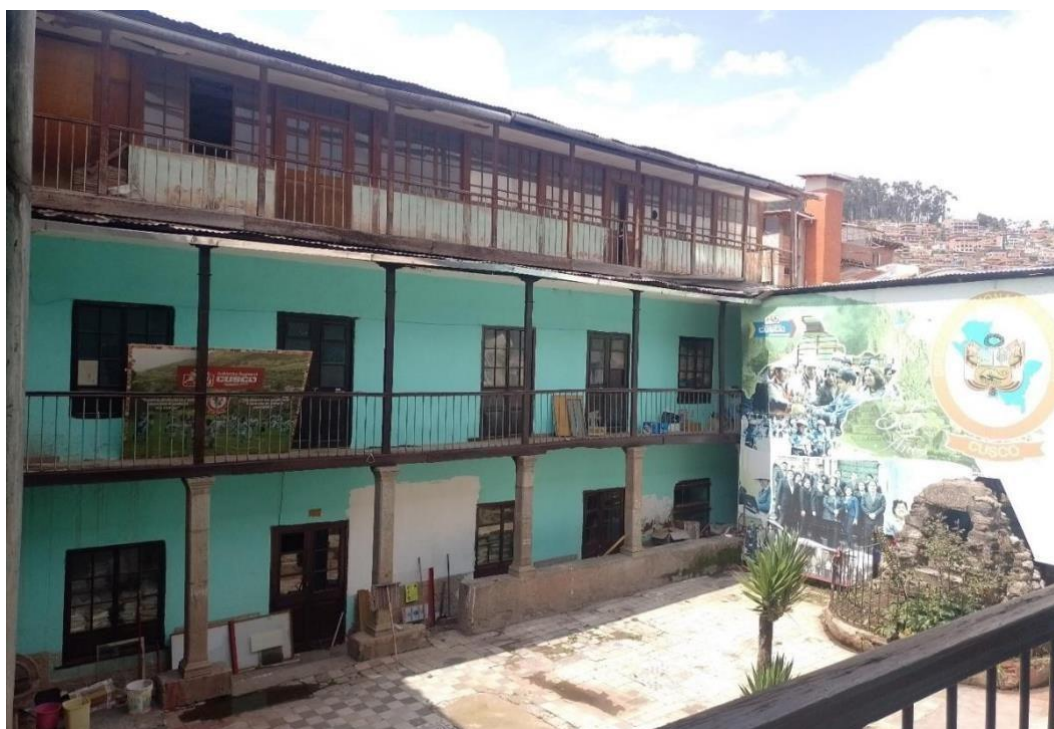
FOTO 3: Segundo patio de la Gerencia Regional de Educación Cusco, el tercer piso que se observa se encuentra inhabitable
